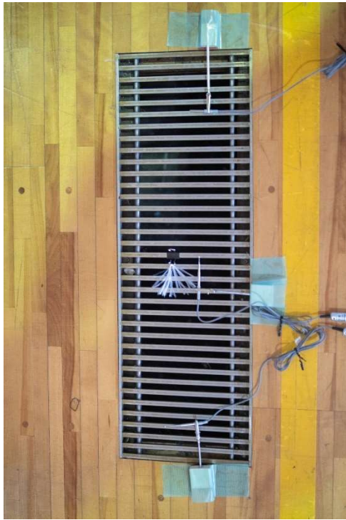
床ガラリ風速：多点風速計
